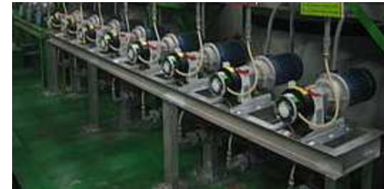
Dosificación de sulfato de alúmina en agua de proceso
