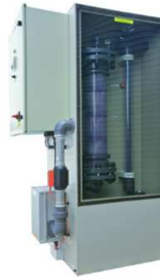
Post-Cloración ETAP de Jaca (Huesca)
