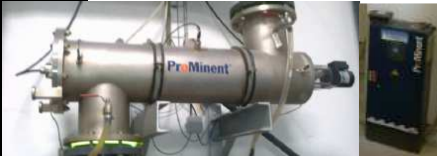
Desinfección agua de proceso en CocaCola Martorelles (BCN)
