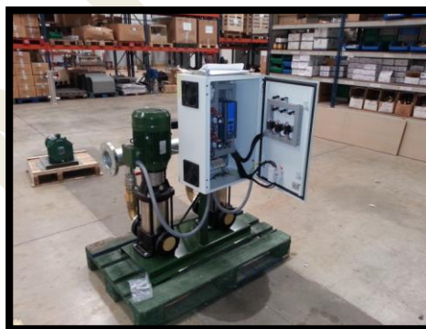
Figura 8. Diseño, fabricación e instalación de grupos de presión, cuadros eléctricos y accionamiento de equipos hidromecánicos.
